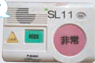
緊急通報装置
